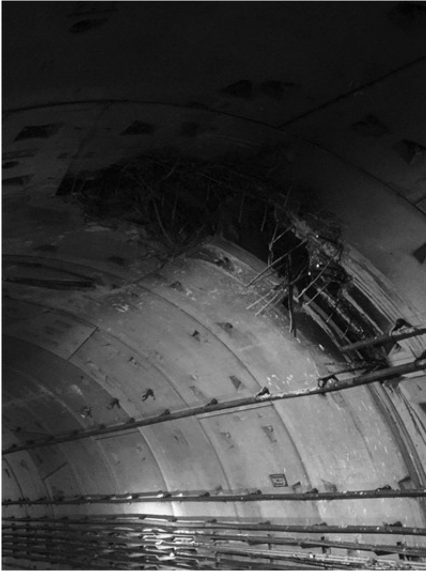
地铁线路隧道顶部被凿穿
